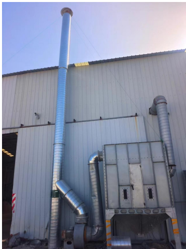
袋式除尘器及 DA001 排气筒
