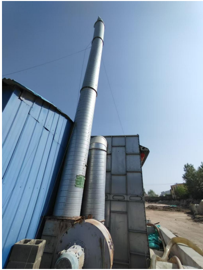
袋式除尘器及 DA002 排气筒
